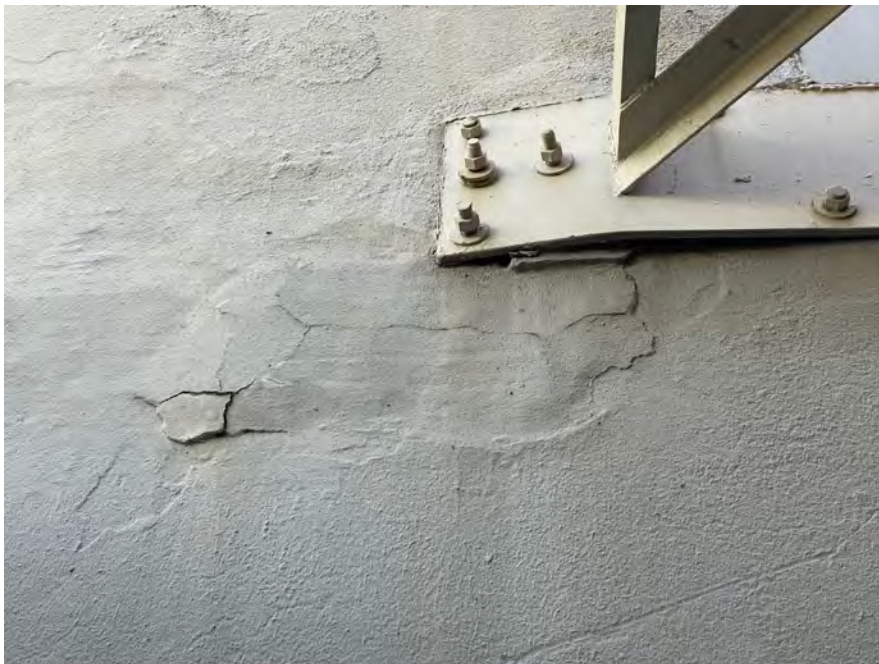
E - 26: Stucco spalls
